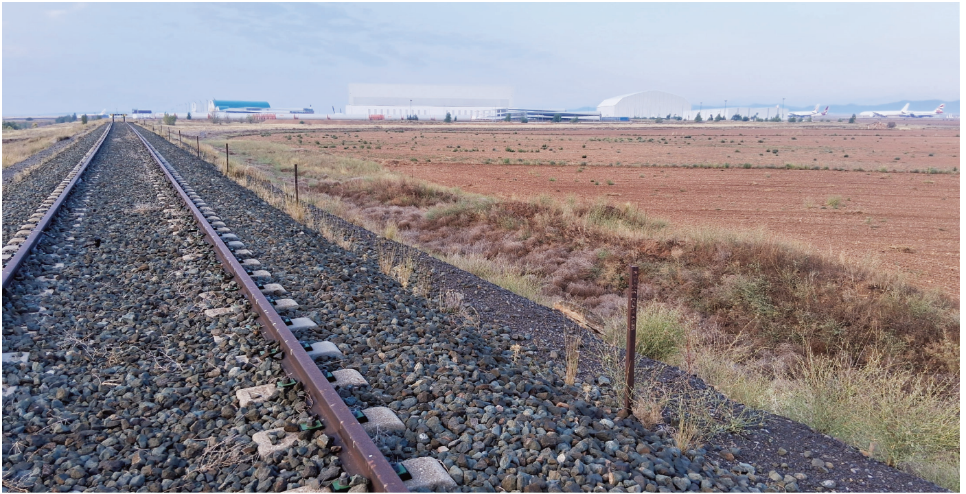
Apartadero ferroviario en la plataforma logística-industrial de Teruel (Platea)
